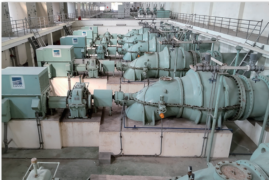
Yên Sở (イェンソー)ポンプ場
