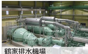
鶴家排水機場 宮城県石巻市
