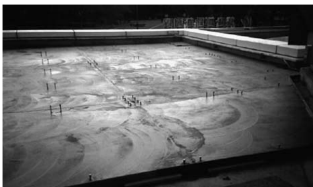
写真3 基礎モルタル打設完了風景 Photo 3 Completion of mortar foundation placement
