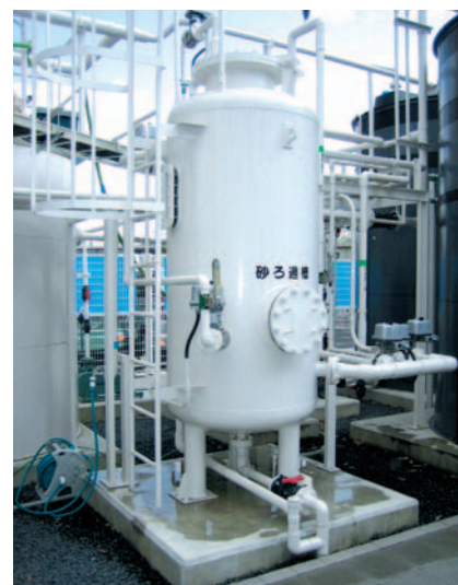
写真3 砂ろ過塔 Photo 3 Sand filtration
