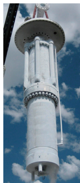
写真 サクシヨンポットから取外した直後の高圧多段ポンプ Photo Typical vessel mounted high pressure pump during removal from the vessel
