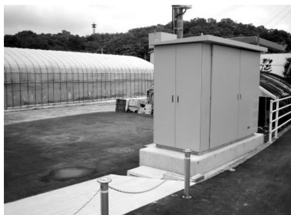
写真2 実機1号機 Photo 2 System No.1
