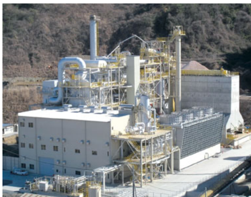
写真1 設備全景 Photo 1 General view
