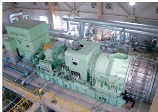
写真4 蒸気タービン Photo 4 Steam turbine
